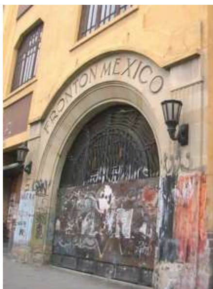
Imagen 40. Graffiti encontrado en una marcha exploratoria de seguridad.
